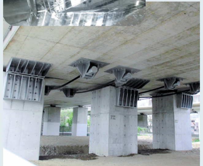
高架橋の落橋防止装置 Bridge collapse prevention device
