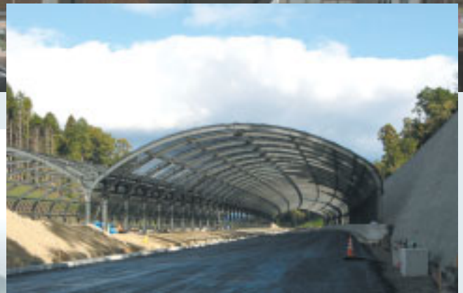
新名神高速道路 防球ネット支柱(タナカ-CZ) Poles for sports nets on Shin-Meishin Expressway (Tanaka-CZ)
