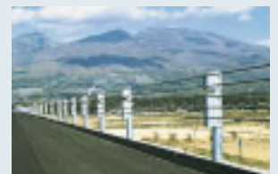
ガードケーブル Cable guardrail
